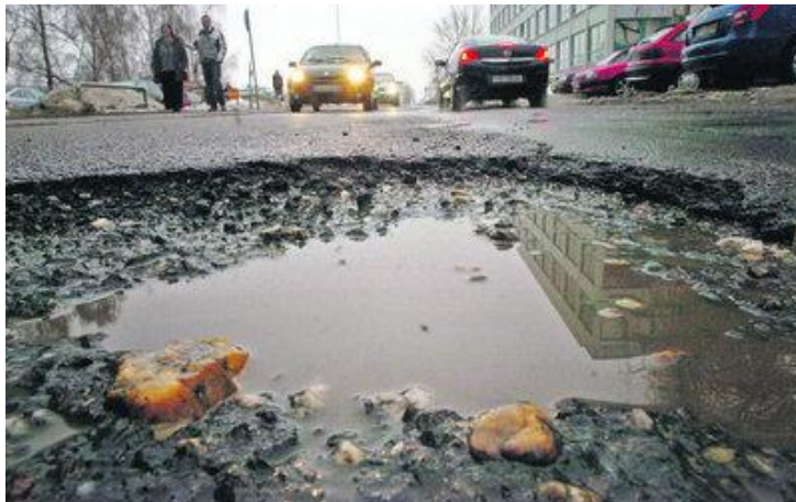
Auf Halles Straßen, zum Beispiel in der Grenzstraße, bilden sich zurzeit reihenweise Schlaglöcher, die den Autos heftig zusetzen. (FOTO: GÜNTER BAUER)
